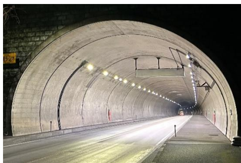
(国道2号 高山トンネル・照明設備)
